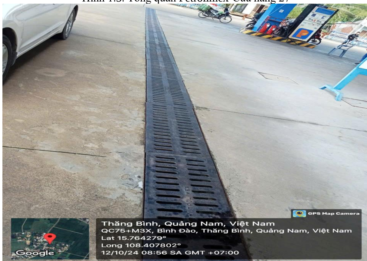
Hình 1.4. Hệ thống thu gom nước mưa nhiễm dầu
