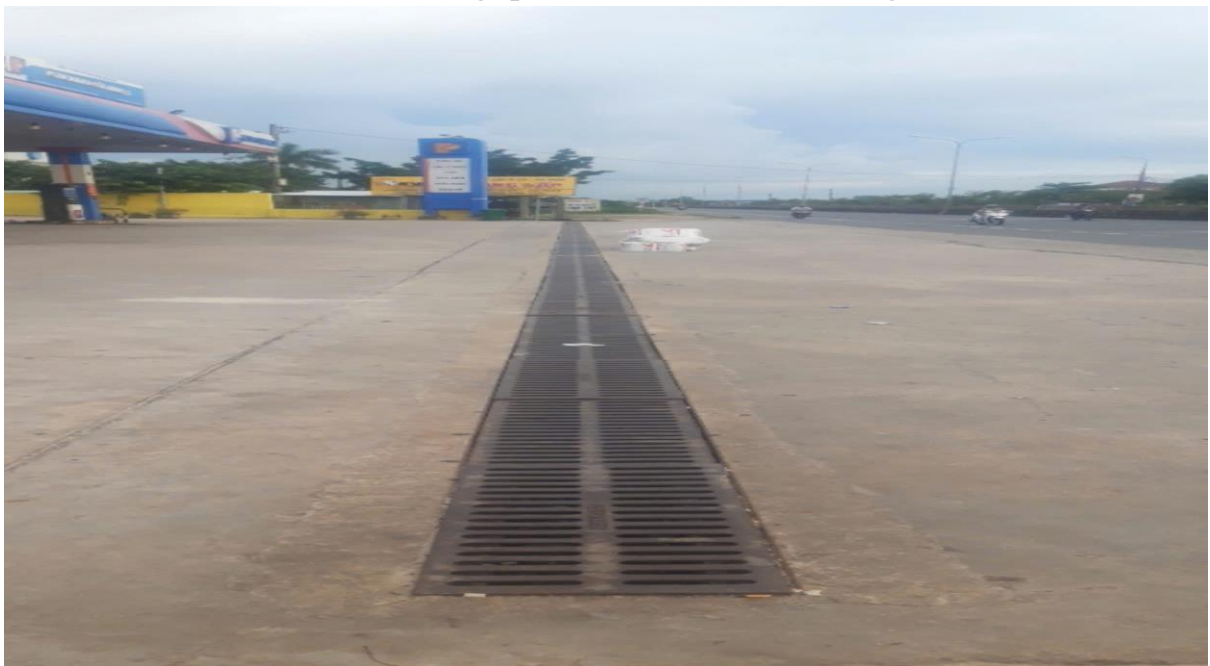
Hình 1.4. Hệ thống thu gom nước mưa nhiễm dầu
