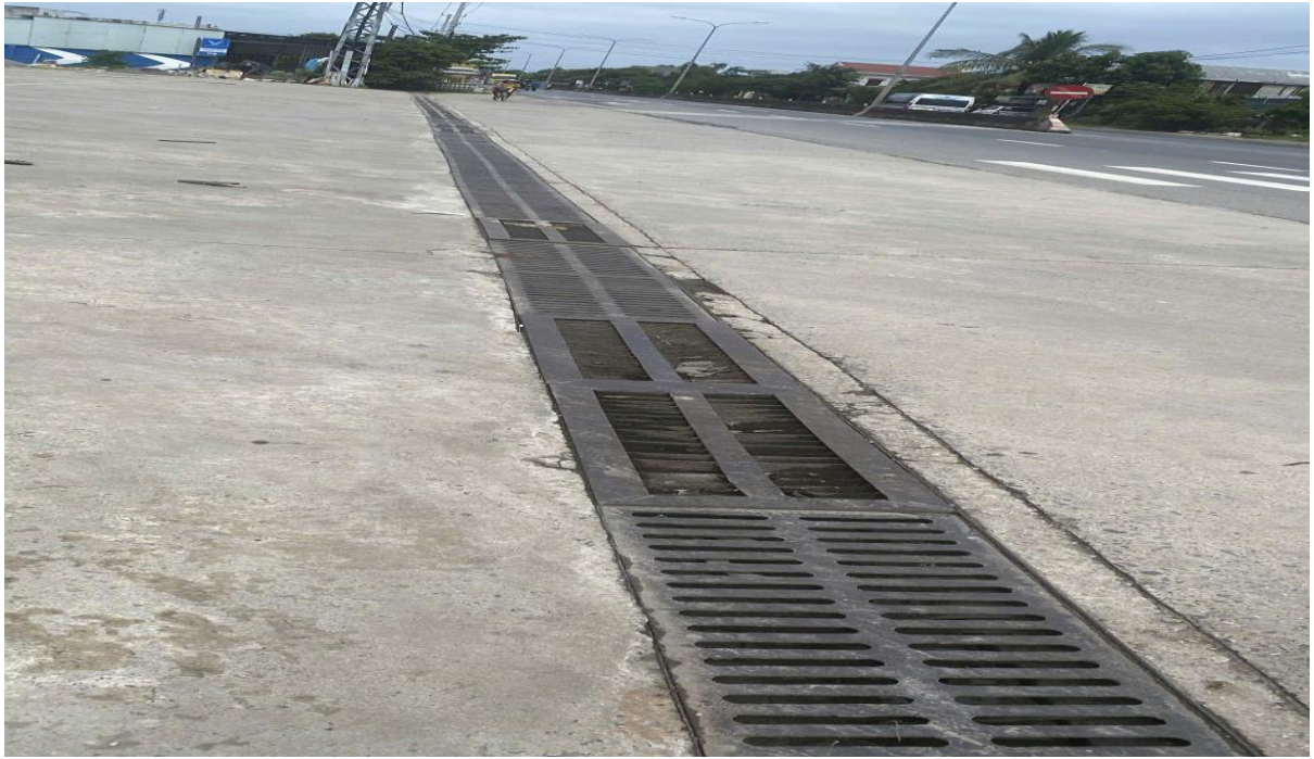
Hình 1.4. Hệ thống thu gom nước mưa nhiễm dầu
